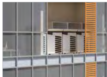
L'unité extérieure est escamotée à l'intérieur du bâtiment sans affecter l'image globale du bâtiment.
